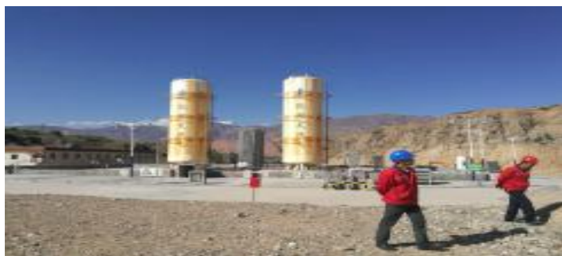
气化站放散管
