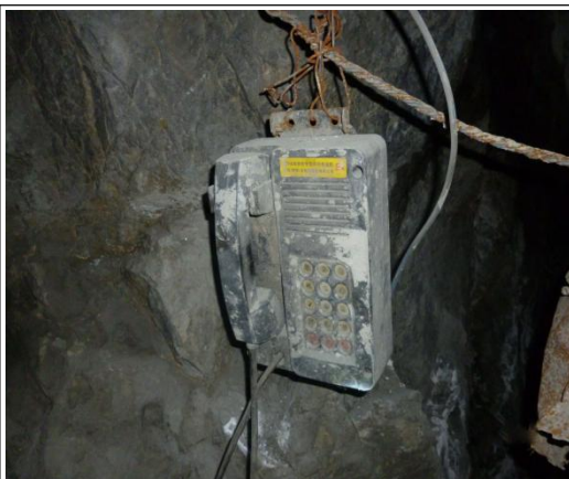
井下通讯设施
