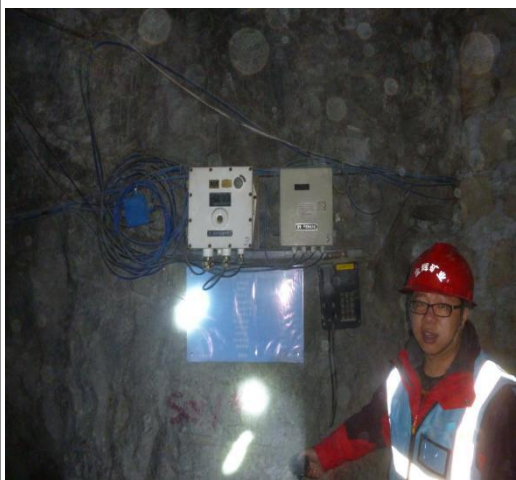
井下通讯基站
