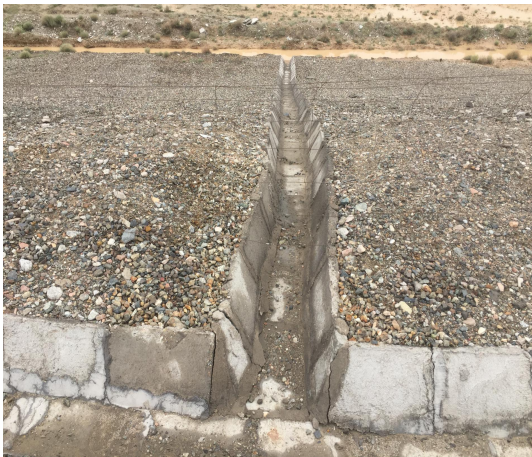
排水沟连接处
