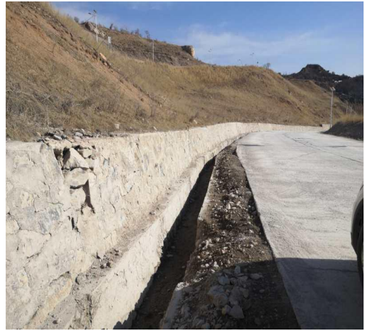
矿山道路排水沟
