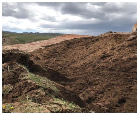
境界外排水沟
