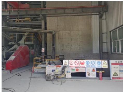
破碎车间内部
