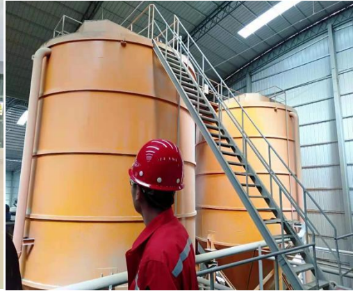
浓缩罐检修斜梯及扶手
