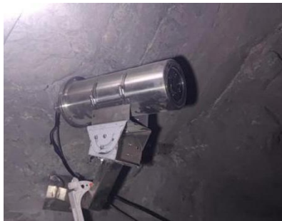
井下监控摄像头
