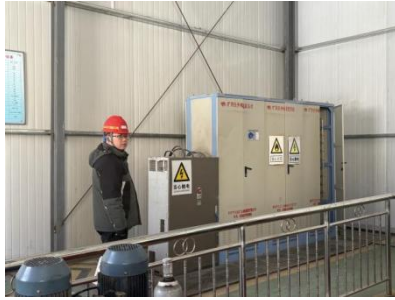
SJ8-1 竖井口提升机房配电柜
