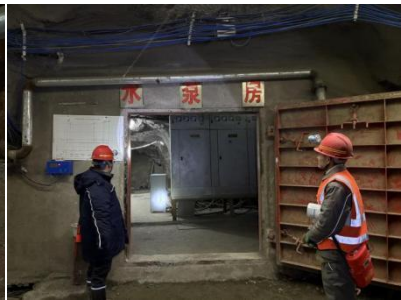
3150m 中段水泵房
