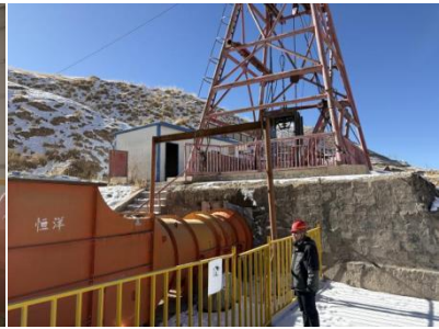
SJ6-1 竖井口风机及快速更换设施
